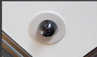
防犯カメラ (9台設置) 建物の状況を24時間監視します。
